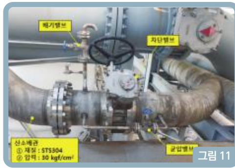
[그림 11] 균압배관 측방향 [그림 12] 균압배관 하방향(잘못 설치)
